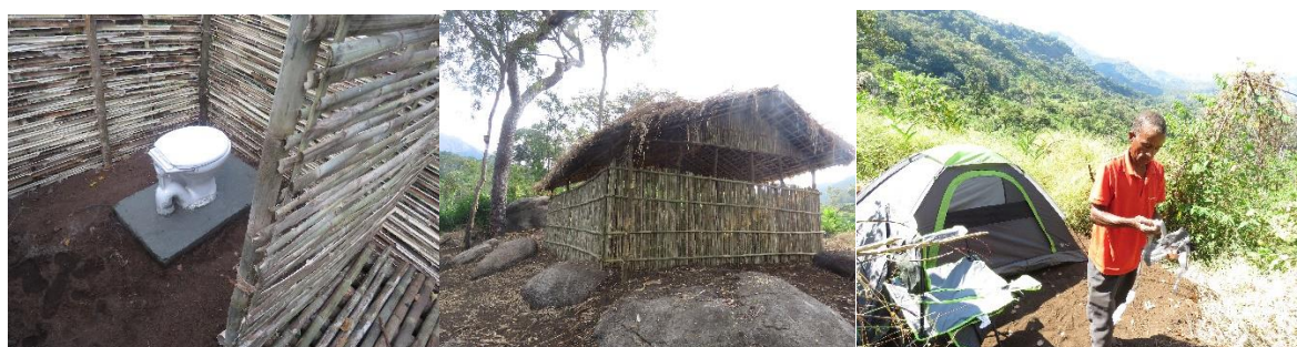
Figuras: algumas infraestruturas básicas criadas no centro de pesquisas e de visitantes para receber missão da União Europeia e dar início às obras de construção de centro de pesquisas
