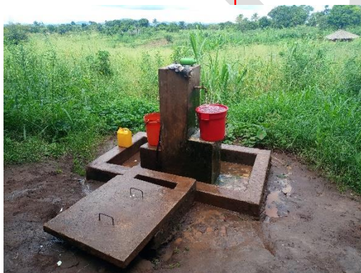
Figura.12.4. Fontenário operacional (Limbúé)
