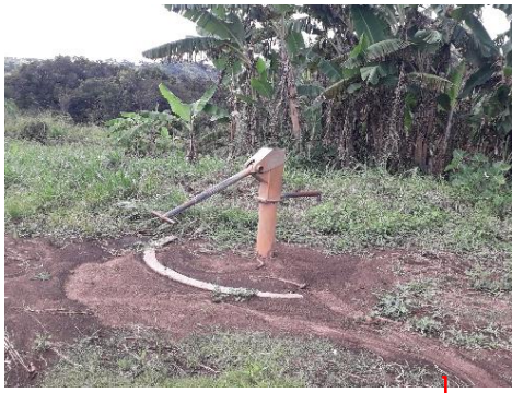
Figura.12.1. Fontenário avariada (Dabuada)
